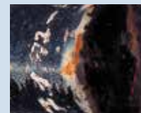
Uten sinkbeskyttelse. Synlig korrosjon.
